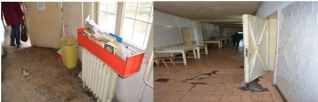
Подовата настилка в тесните коридорите е захабена с пропадали и изпочупени плочки
