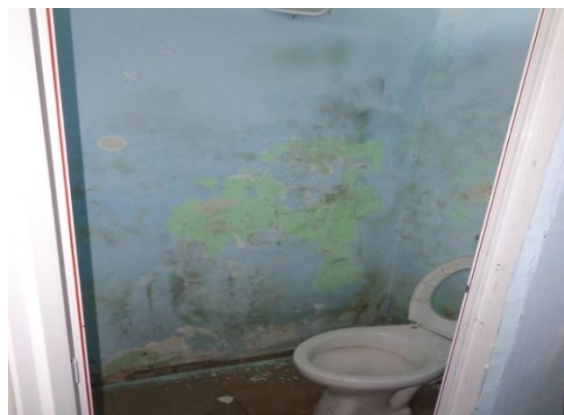
Санитарно помещение с влага по стената
