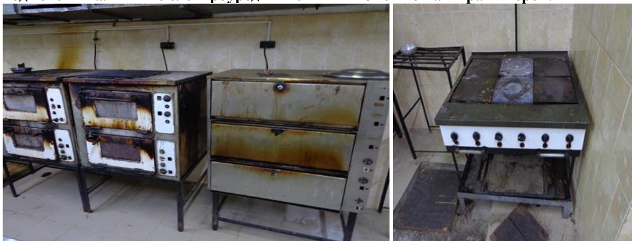
Електроуреди в кухнята на Затвор Варна
