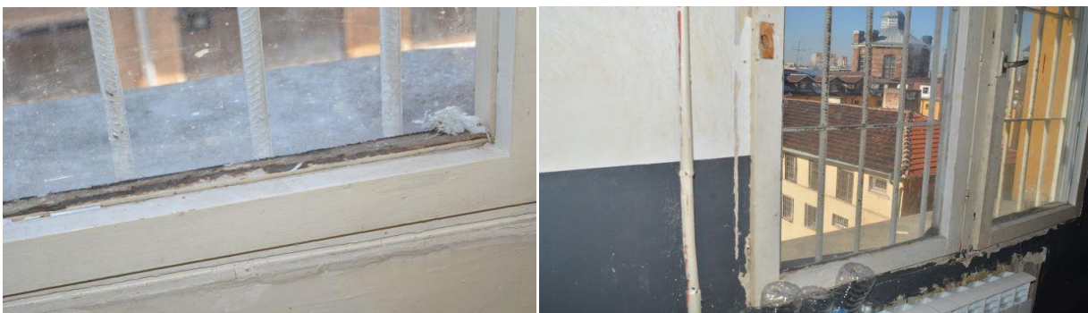
Състояние на дървената дограма
