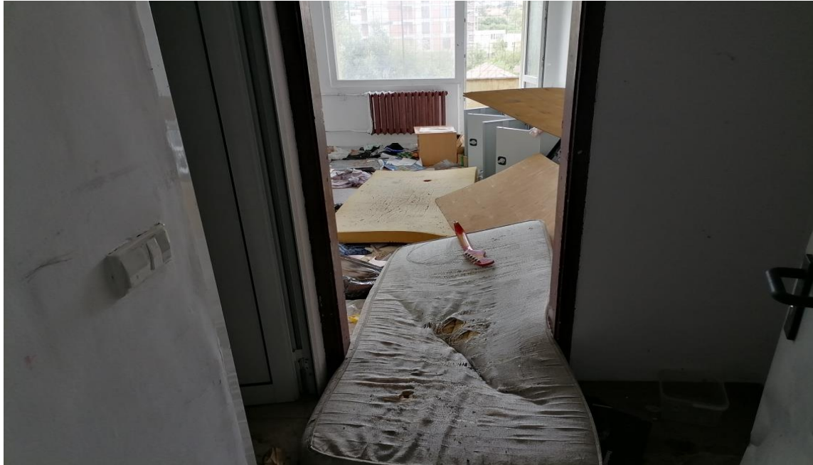
Състояние на третия етаж на блок „А“ в РПЦ-София
