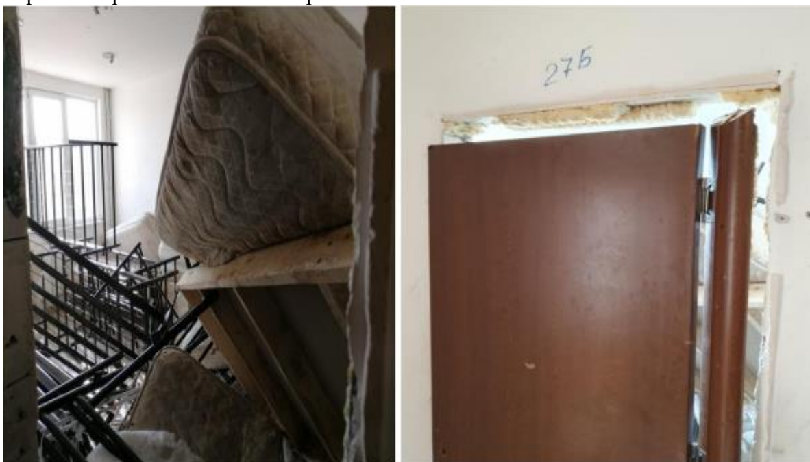
Ползваната за склад в Девето хале стая 27Б, с паднала каса, поради липса на крепежни елементи
