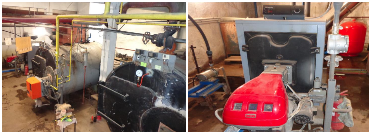
Котелното помещение в Затвор Варна
