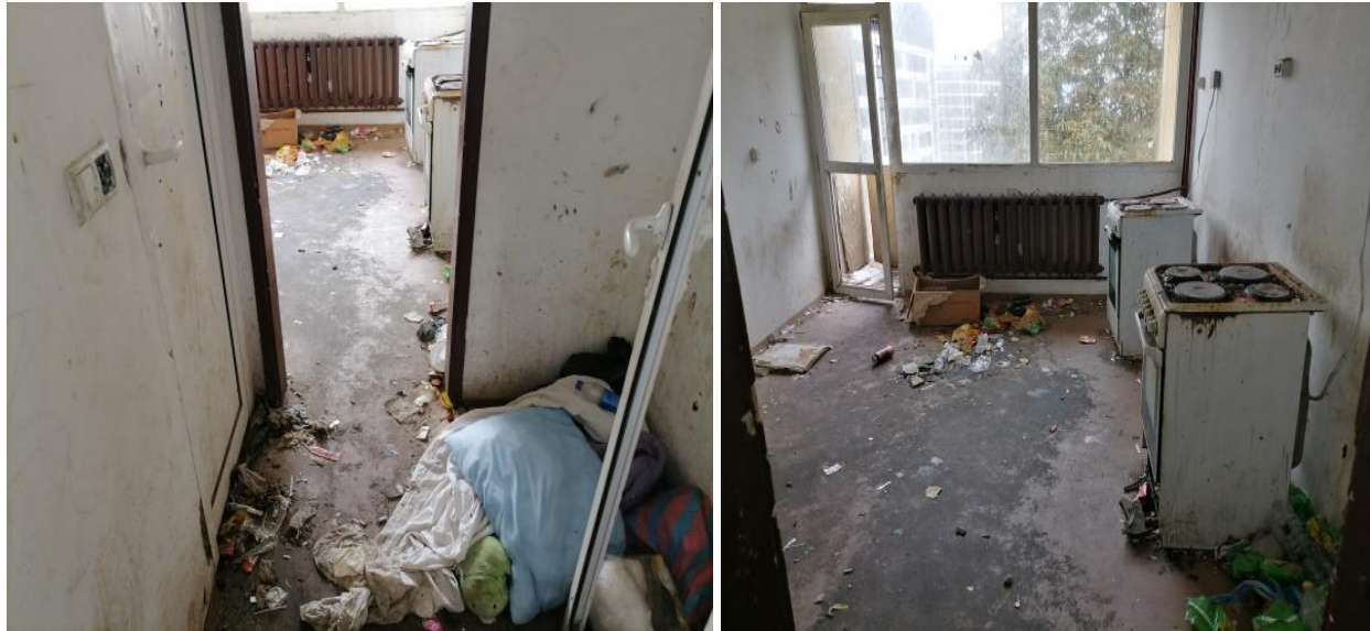
Унищожената и нефункционираща кухня на третия етаж в РПЦ - София
