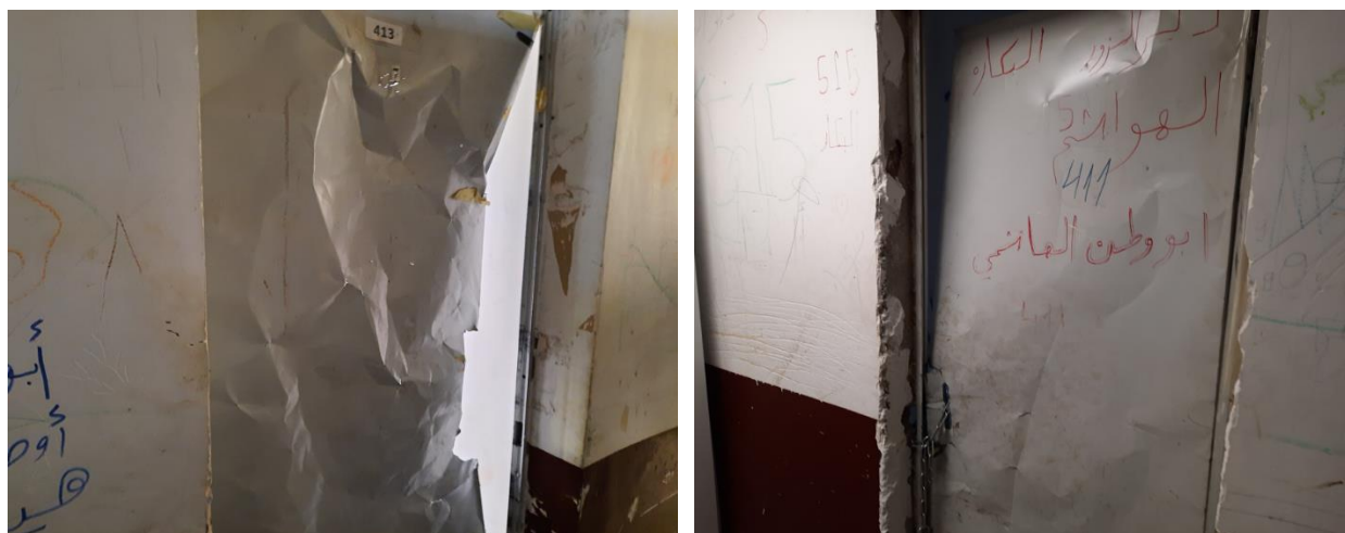
Част от разбитите врати на помещенията за настаняване на търсещи закрила
