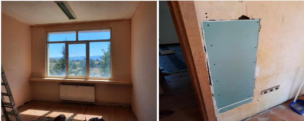
Ремонтни дейности в ПМЗ „Враждебна“ към момента на проверката
