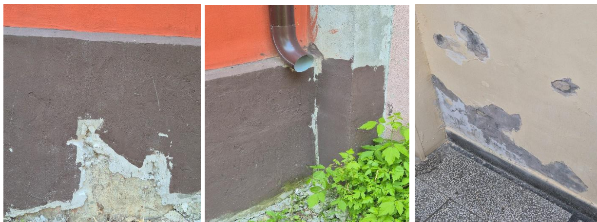
Рушаща се външна мазилка, къса водосточна тръба, която мокри фасадата и паднала мазилка
